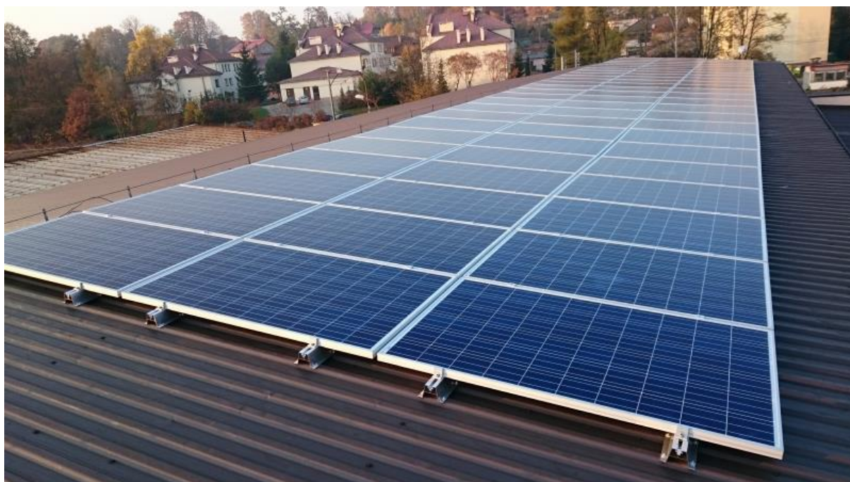
Rysunek 2. Widok instalacji zbudowanej na bazie systemu CORAB T-02.
